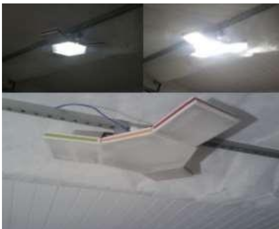
Imagem 1. Luminária LED instalada.
